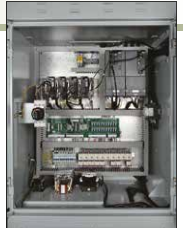
SIEMENS VEYA SCHNEIDER ELEKTRİK KOMPONENTLERİ
